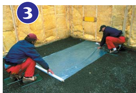
3. Tasandatud kergkruusakihi peale rullitakse laiade hüdroisolaator, käesoleval juhul kile. Ülekate paanide vahel peab olema vähemalt 0,5 m. Et mitte rikkuda tasandatud kergkruusakihi pinda, on ehitajad sidunud jalga laiemad plaadid. Nii on välistatud kruusa sisse vajumine.
